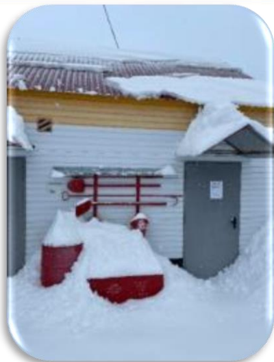
Не очищен снег
