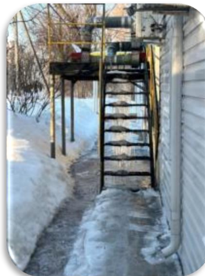
Наледь на дорожках Наледь на ступеньках и площадке ВУ
